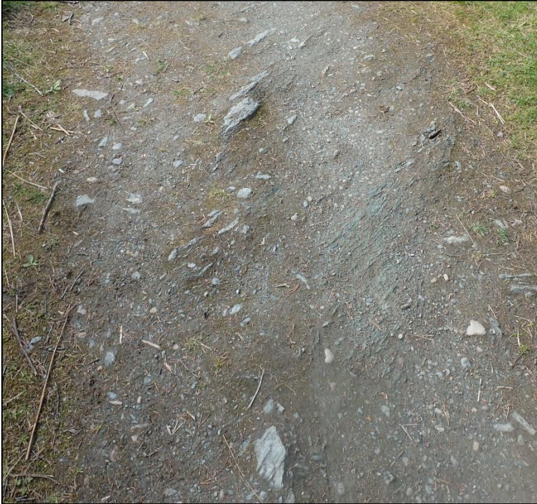
Figur 4: Oppsprukket fjell i grusstien (ledningstrasé).
