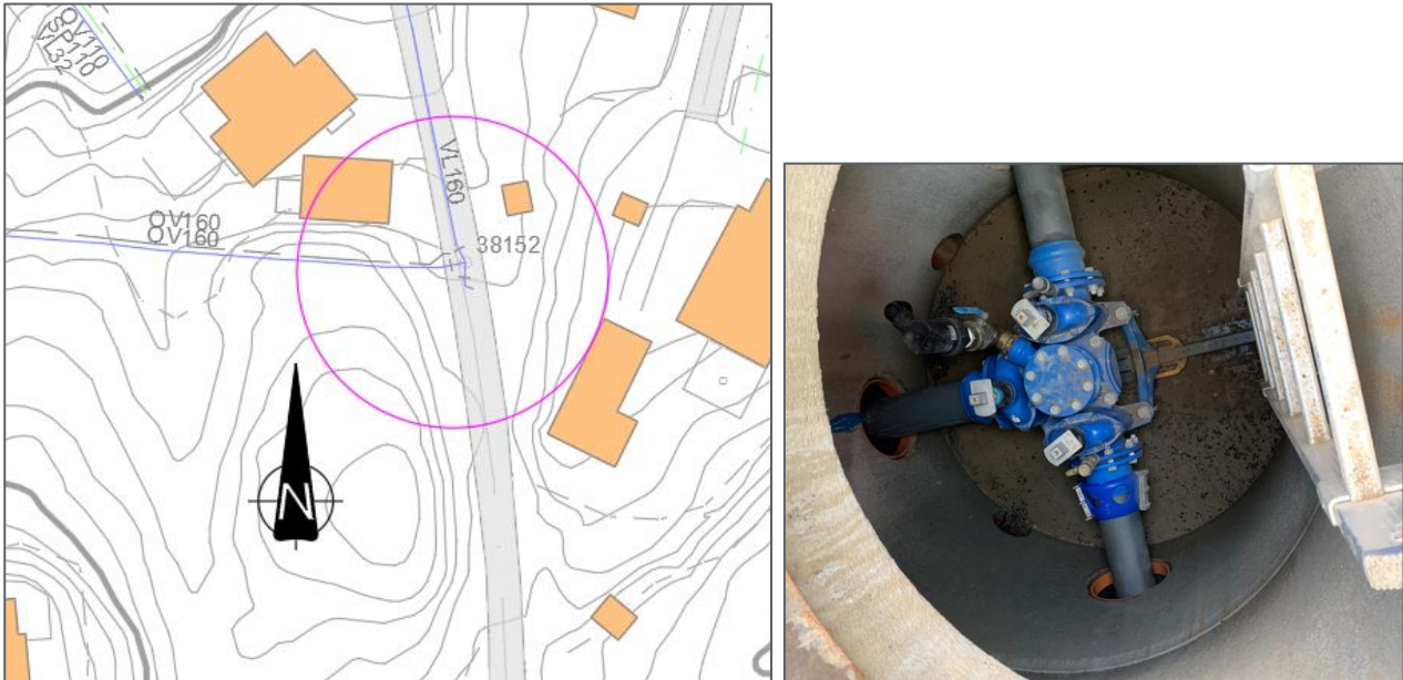
Figur 2: Eksisterende VA og vannkum 38152 ved tilknytningspunkt Nord (Hesttrøa)
